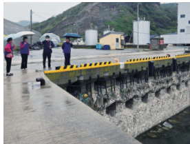
輪島市鹿磯(かいそ)漁港。 4メートルの隆起が発生
