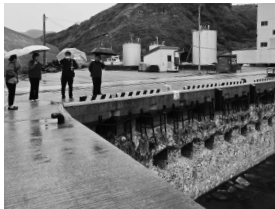
輪島市鹿磯(かいそ)漁港。 4メートルの隆起が発生
